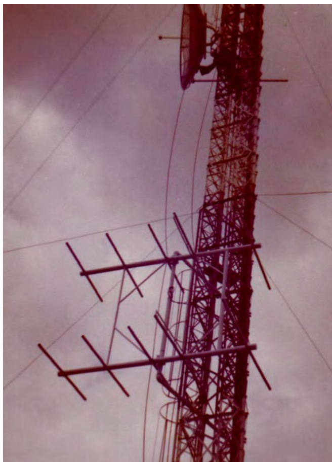
RPTV de Orlandia no CH 20. Detalhe de arranjo de Yagis de recepção do ARCH 3 de Ribeirão Preto com Link STD BY/ Fotos: Arquivo Pessoal
