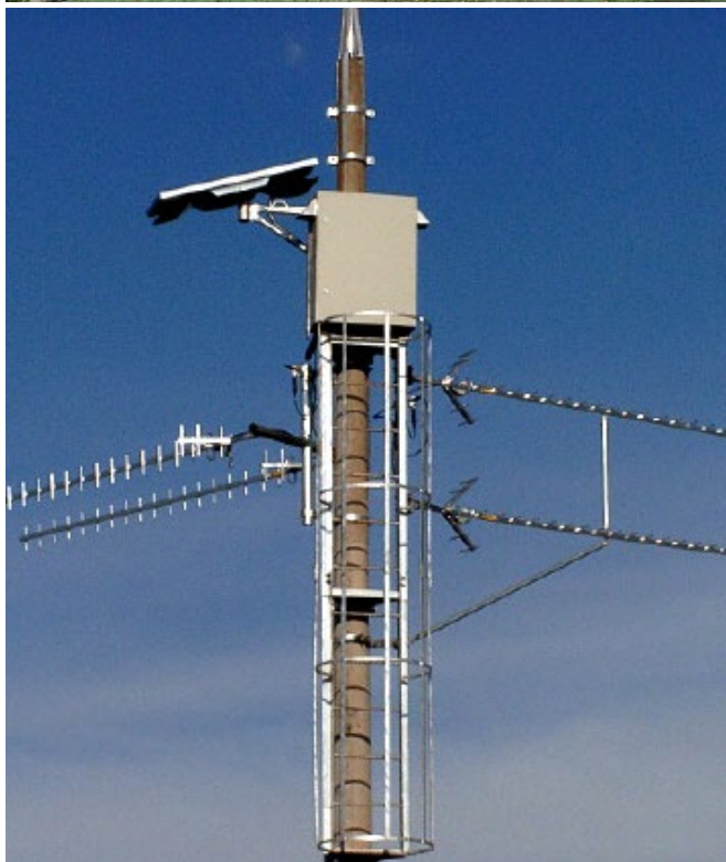
Acima: Container para Mini Site da EPTV em Leme/SP CH UHF. Abaixo: Nano site em Ipuã/SP CH 60 SFN com energia solar. Ambos do Grupo EPTV/ Foto: Arquivo Pessoal
