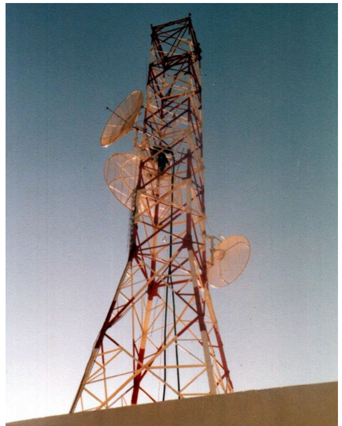
Torre Mirante da Laginha em Águas de Prata (SP) com parabólicas em dia de alinhamento dos enlaces: 3,0 m RX de Amparo UHF foi modificada P/SHF; 2,4 m TV para São José do Rio Pardo (SJRP) modificada P/SHF; e 4,5 m TX para Santa Rita do Passa Quatro (SRPQ) com fabricação da TV Cultura / Foto: Arquivo Pessoal
