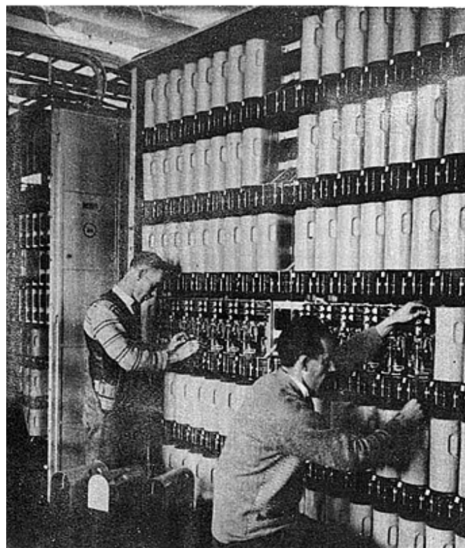
Central de chaveamento telefônico por circuito, que posteriormente seria substituída por componentes de software podendo rodar em computadores comuns /Foto: Marvin Hodges
